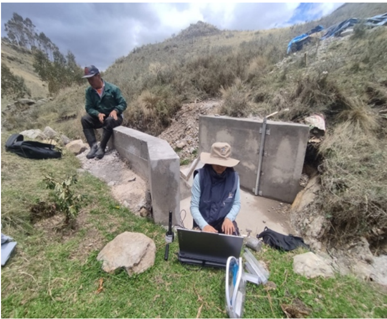
Implementación del Sistema de Monitoreo Hidrológico – SMH con la instalación de 02 estaciones hidrométricas SMH – Vertederos / sensores de agua.
